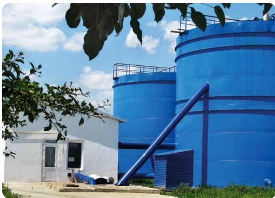
Очистные сооружения – важная часть современного животноводческого комплекса
