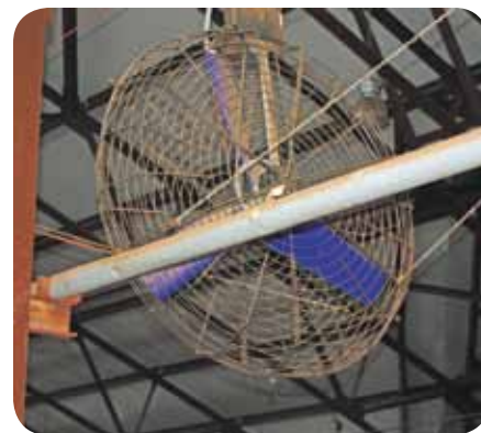
Здание оснащено современной системой вентиляции
