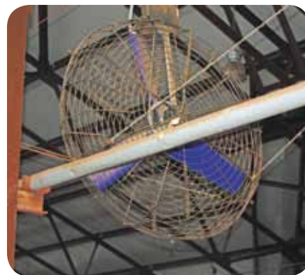
Здание оснащено современной системой вентиляции
